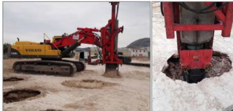
Figura 4. Equipo de compactación RIC.
