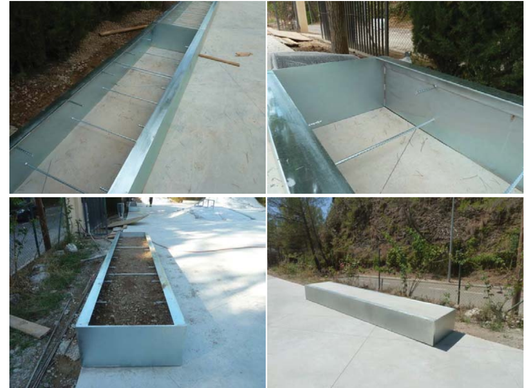
Soldadura llisa i continua entre l'angular i la vora dels calaixos "M". Connectors, etc. Reomplert i Acabats. Exemple d'obstacles semblants( en acer galvanitzat, en lloc de corten) com a exemple.
