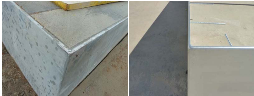
Arestes i cantonades "matejades" a taller, abans del galvanitzat, per evitar punxes o fils que tallin.
